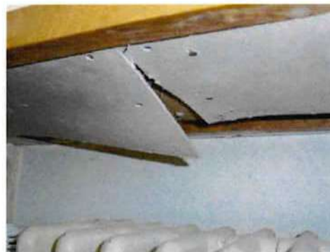
3 Asbesthaltige Leichtbauplatten als Brandschutzverkleidungen, z.B. bei Radiatoren
